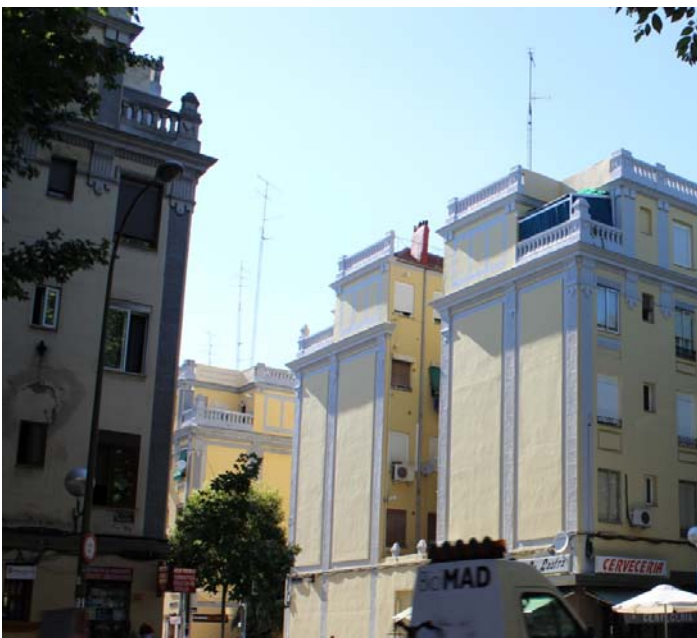
Imagen 25: A la izquierda, fachada con humedades; a la derecha, fachada arreglada.
