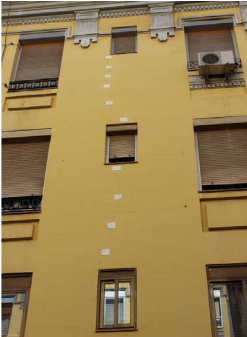
Imagen 8: Testigos en una grieta en una fachada de la colonia.
