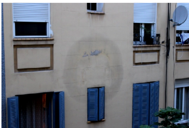
Imagen 21: Gran mancha de humedad bajo la ventana del cuarto de baño.
