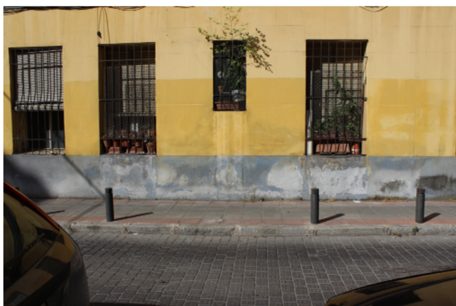
Imagen 7: Humedades en la planta baja.
